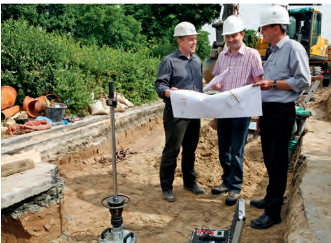
Die Gütesicherung der Gütezeicheninhaber durch Firmen- und Baustellenbesuche zählt zu den Aufgaben der Prüflingenieure.
