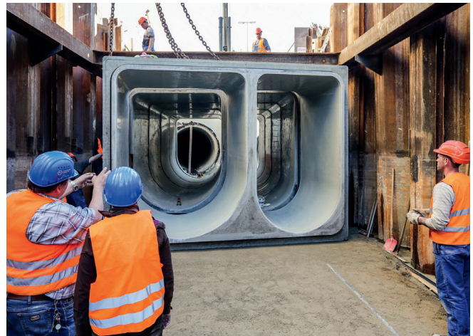
HAMBURG WASSER fordert in seinen Ausschreibungen die Erfüllung der Anforderungen der Gütesicherung Kanalbau RAL-GZ 961. Und auch während der Bauphase wird der Auftraggeber in vielfältiger Weise von den Prüfingenieuren der Gütegemeinschaft unterstützt. Fotos: HAMBURG WASSER
