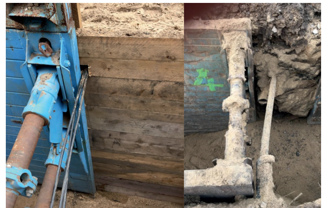
Abb. 3: Fachgerecht (l.) und unsachgemäß (r.): Aussparungen im Verbausystem sind grundsätzlich nicht zulässig – die Verkleidung muss vollflächig sein.
