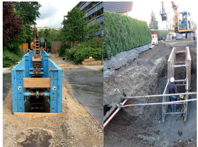
Abb. 1: Fachgerecht (l.) und unsachgemäß (r.): Nicht fachgerecht eingestellter Verbau hat Einfluss auf das Gleichgewicht des umliegenden Erdreiches und kann zum Beispiel zu Setzungen führen, welche die angrenzende Bebauung erheblich schädigen kann.
