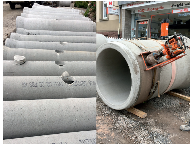
Abb. 3 und 4: Nicht fachgerecht (l.): Mittig oder gegenüber hergestellte Anschlussbohrungen und deren mögliche Folgen. Fachgerecht (r.) Das Bohrgerät ist mit Spannband fixiert und die Bohrung wird an der richtigen Stelle ausgeführt.
