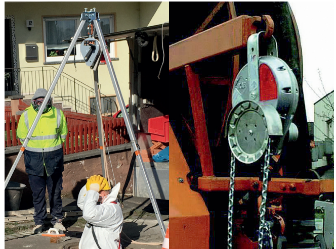
Abb. 1 und 2: Nicht fachgerecht (l.): Der Anschlagpunkt ist nur für die Absturzsicherung geeignet, nicht für die Verwendung eines Höhensicherungsgerätes mit Kurbel zur Personenrettung. Fachgerecht (r.): Eine Rettungshub-Funktion hängend an einem geeigneten Anschlagpunkt ist nur mit Haspelkettenantrieb möglich.
