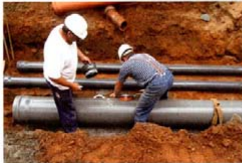
Wissen wie es geht: Weiterbildung sichert die Qualifikation der Mitarbeiter, die damit auf dem aktuellen Stand der Technik sind. Foto: Güteschutz Kanalbau
