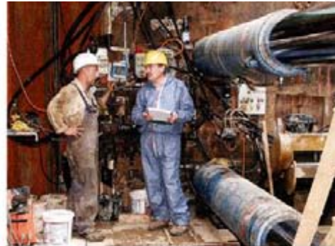
Für den Güteausschuss vor Ort: Im Rahmen der Gütesicherung besuchen die Prüffingenieure stichprobenartig die von den Firmen gemeldeten Einsatzstellen.
