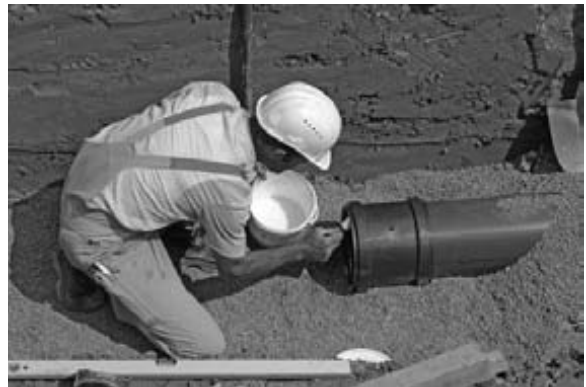
Firmen, die ein Gütezeichen Kanalbau führen, sind der geeignete Partner für den fachgerechten Einbau von Kanalrohren.
