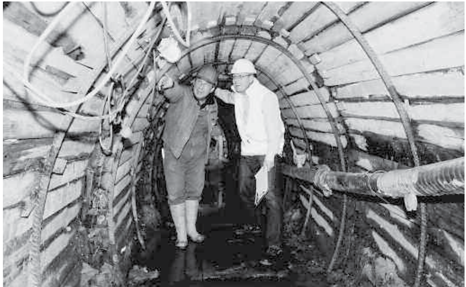
Die Gütesicherung der Gütezeicheninhaber durch Firmen- und Baustellenbesuche zählt zu den Aufgaben der Gütegemeinschaft Kanalbau.
