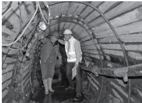
Die Gütesicherung der Gütezeicheninhaber durch Firmen- und Baustellenbesuche zählt zu den Aufgaben der Gütegemeinschaft Kanalbau.
