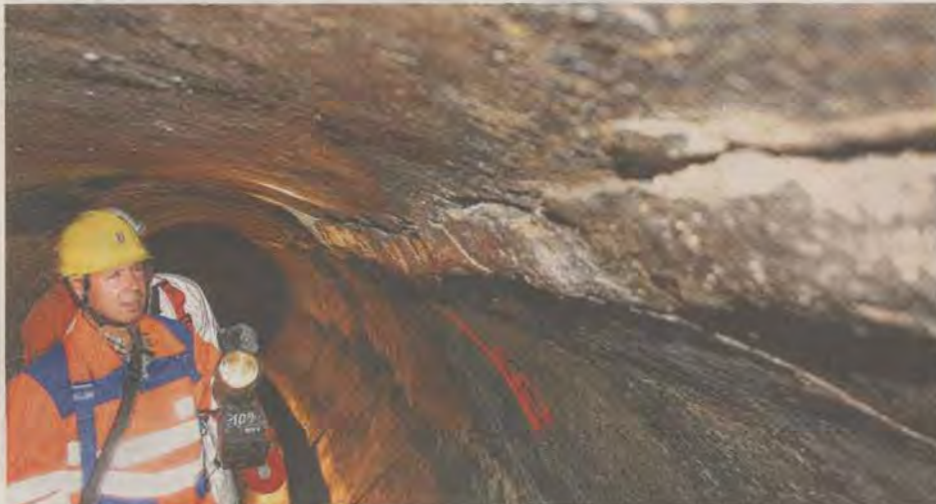
Schäden in der Kanalisation müssen rechtzeitig erkannt und beseitigt werden. FOTO: LANDESHAUPTSTADT STUTTGART
