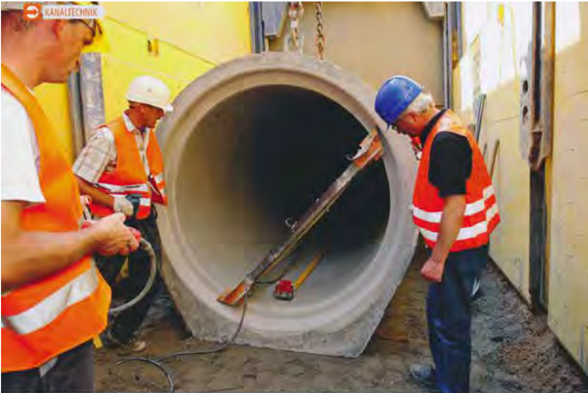
Neben der fachgerechten Ausführung der Maßnahmen beeinflussen die Ingenieurleistungen wie Planung, Ausschreibung und Bauüberwachung das Ergebnis von Kanalbaumaßnahmen. Foto: Güteschutz Kanalbau
