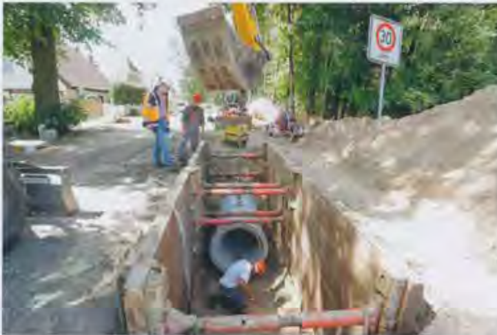
Das Zusammenwirken von Bettung, Bauteil und Verfüllung ist Grundlage für die Stand- und Betriebssicherheit von Rohrleitungen. | Abbildung: Güteschutz Kanalbau.
