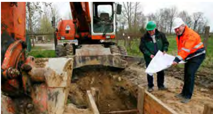
Bild 2: Mit der Aktion des Güteschutz Kanalbau, den Gütezeicheninhabern das Technische Regelwerk zur Verfügung zu stellen, schafft die Gütegemeinschaft weitere Voraussetzungen zur Verbesserung der Qualität bei der Herstellung von Abwasserleitungen und -kanälen
