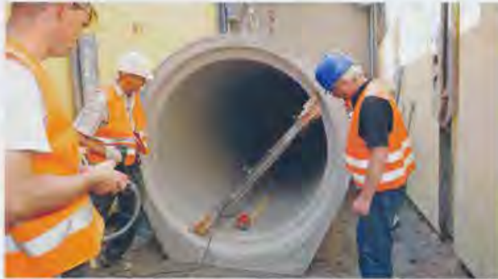
Neben der fachgerechten Ausführung der Maßnahmen beeinflussen die Ingenieurleistungen wie Planung, Ausschreibung und Bauüberwachung das Ergebnis von Kanalbaumaßnahmen. | Fotos: Güteschutz Kanalbau
