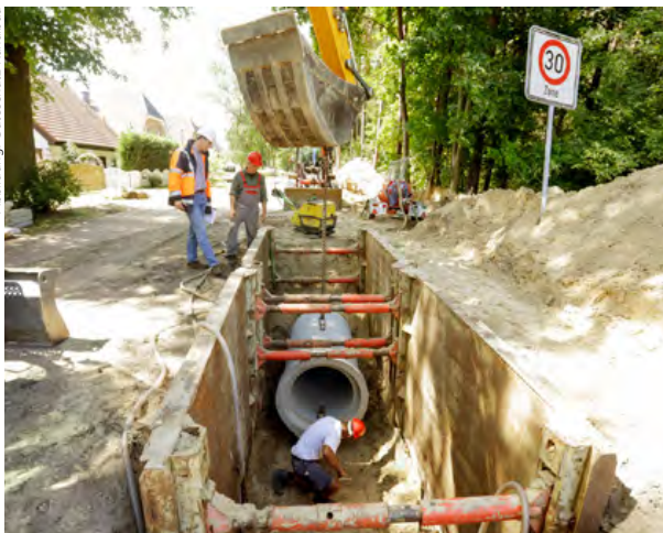
Bild 1: Das Zusammenwirken von Bettung, Bauteil und Verfüllung ist Grundlage für die Stand- und Betriebssicherheit von Rohrleitungen
