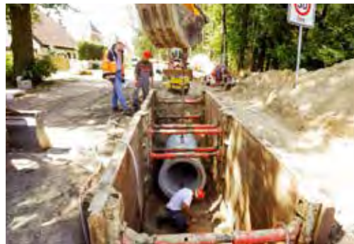
Abb. 1: Das Zusammenwirken von Bettung, Bauteil und Verfüllung ist Grundlage für die Stand- und Betriebssicherheit von Rohrleitungen. Abbildung: Güteschutz Kanalbau
