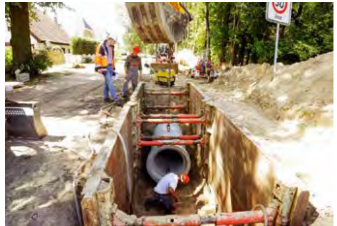
Abb. 1: Das Zusammenwirken von Bettung, Bauteil und Verfüllung ist Grundlage für die Stand- und Betriebssicherheit von Rohrleitungen. Abbildung: Güteschutz Kanalbau
