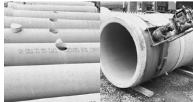
Nicht fachgerecht (l.): Mittig oder gegenüber hergestellte Anschlussbohrungen und deren mögliche Folgen. Fachgerecht (r.): Das Bohrgerät ist mit Spannband fixiert, und die Bohrung wird an der richtigen Stelle ausgeführt.
