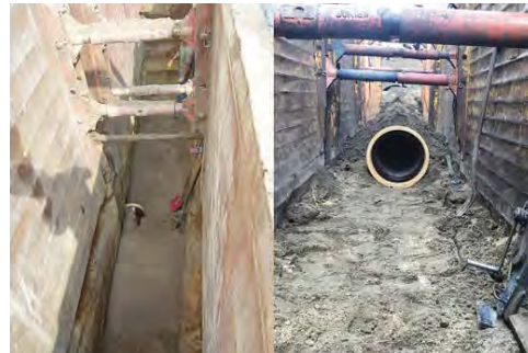
Bild 4. Unsachgemäß bzw. fachgerecht: Die extreme Abweichung zwischen Rohr- und Verbauachse macht eine fachgerechte Herstellung der Bettung und der Zwickelverdichtung nicht möglich (l.). Einbau des Rohres mit beidseitig gleichem Arbeitsraum gemäß Regelwerk (r.).
