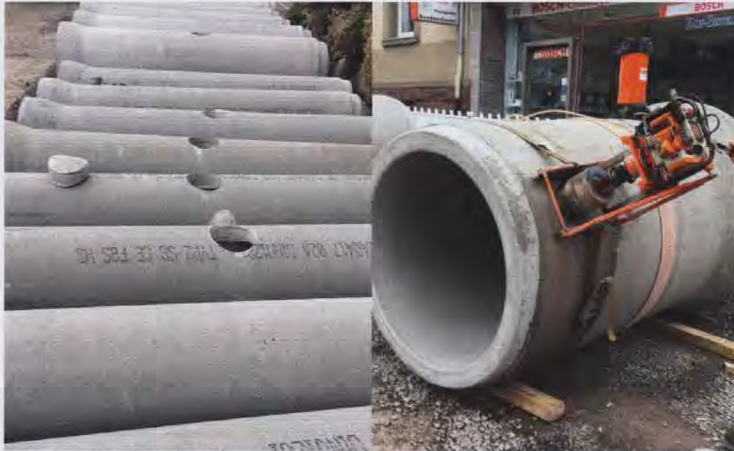
Nicht fachgerecht (l.): Mittig oder gegenüber hergestellte Anschlussbohrungen und deren mögliche Folgen. Fachgerecht (r.) Das Bohrgerät ist mit Spannband fixiert und die Bohrung wird an der richtigen Stelle ausgeführt. Foto: Güteschutz Kanalbau
