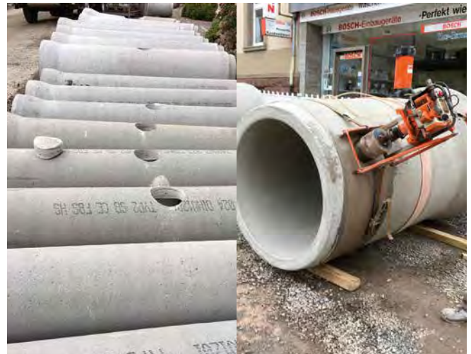
Abb. 3 und 4: Nicht fachgerecht (l.): Mittig oder gegenüber hergestellte Anschlussbohrungen und deren mögliche Folgen. Fachgerecht (r.) Das Bohrgerät ist mit Spannband fixiert und die Bohrung wird an der richtigen Stelle ausgeführt.
