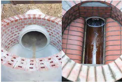
Bild 6. Unsachgemäß bzw. fachgerecht: Verwendung unzulässiger Klinker (l.), fachgerecht hergestelltes Schachtunterteil (r.). (Fotos/Abb.: Güteschutz Kanalbau)
