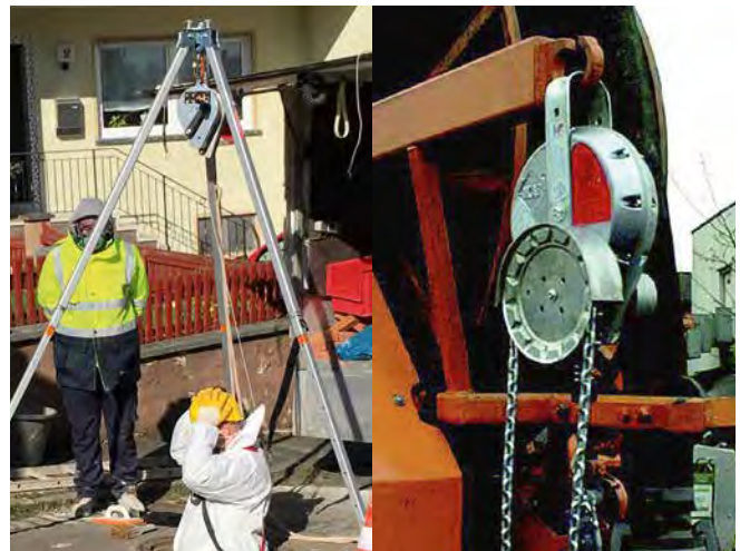
Abb. 1 und 2: Nicht fachgerecht (l.): Der Anschlagpunkt ist nur für die Absturzsicherung geeignet, nicht für die Verwendung eines Höhensicherungsgerätes mit Kurbel zur Personenrettung. Fachgerecht (r.): Eine Rettungshub-Funktion hängend an einem geeigneten Anschlagpunkt ist nur mit Haspelkettenantrieb möglich.
