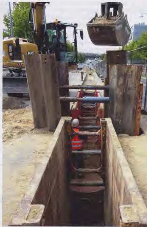
Bei öffentlichen Aufträgen weist die Tiefbau Beschormer und Otto Langenhagen GmbH ihre Eignung gegenüber den öffentlichen Auftraggebern zukünftig unter anderem anhand der Nachweise der PQ-VOB nach.
