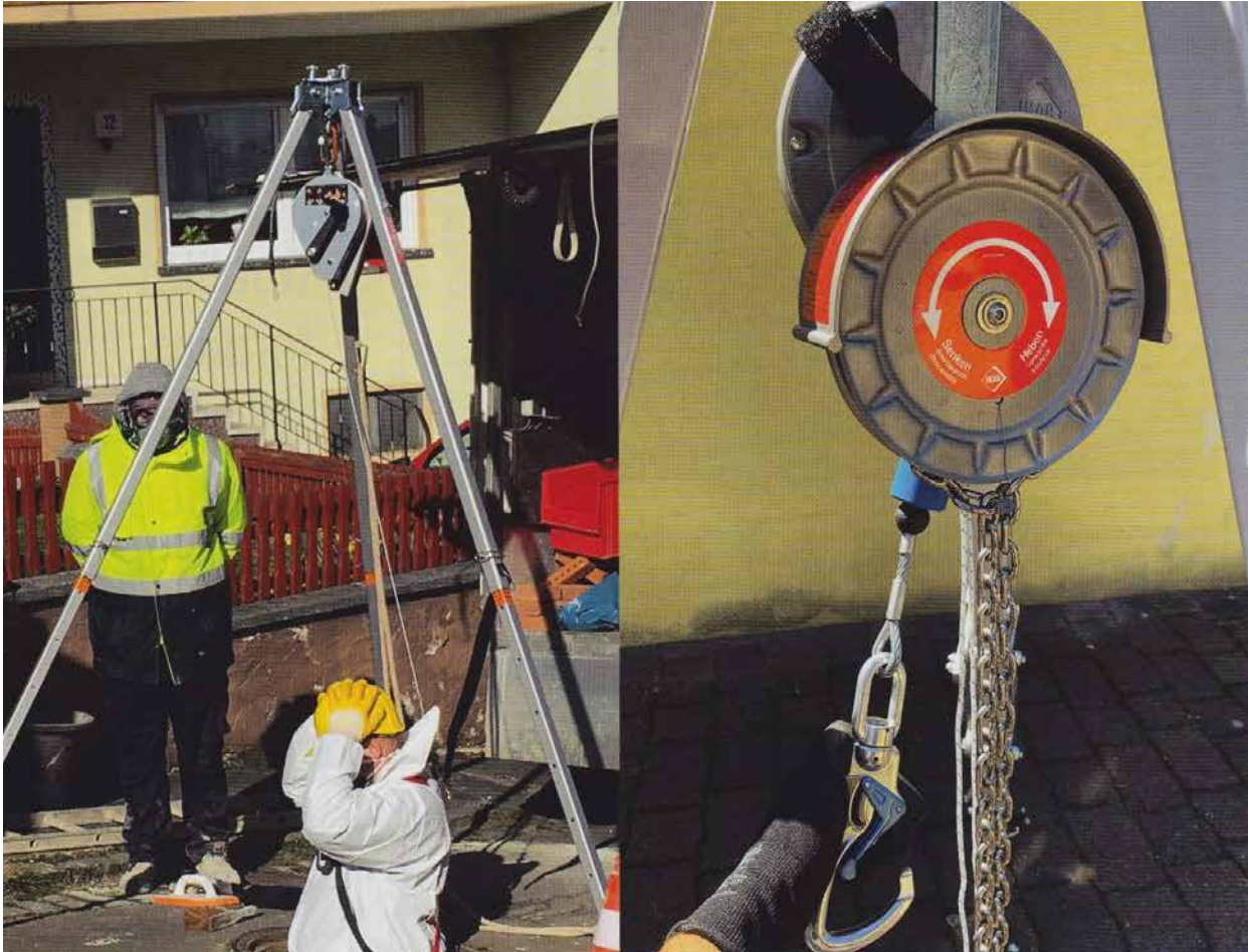
Nicht fachgerecht (l.): Der Anschlagpunkt ist nur für die Absturzsicherung geeignet, nicht für die Verwendung eines Höhensicherungsgerätes mit Kurbel zur Personenrettung. Fachgerecht (r.): Eine Rettungshub-Funktion hängt an einem geeigneten Anschlagpunkt ist nur mit Haspelkettenantrieb möglich.
