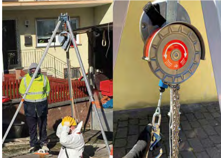
Nicht fachgerecht (l.): Der Anschlagpunkt ist nur für die Absturzsicherung geeignet, nicht für die Verwendung eines Höhensicherungsgerätes mit Kurbel zur Personenrettung. Fachgerecht (r.): Eine Rettungshubfunktion hängend an einem geeigneten Anschlagpunkt ist nur mit Haspelkettenantrieb möglich.
