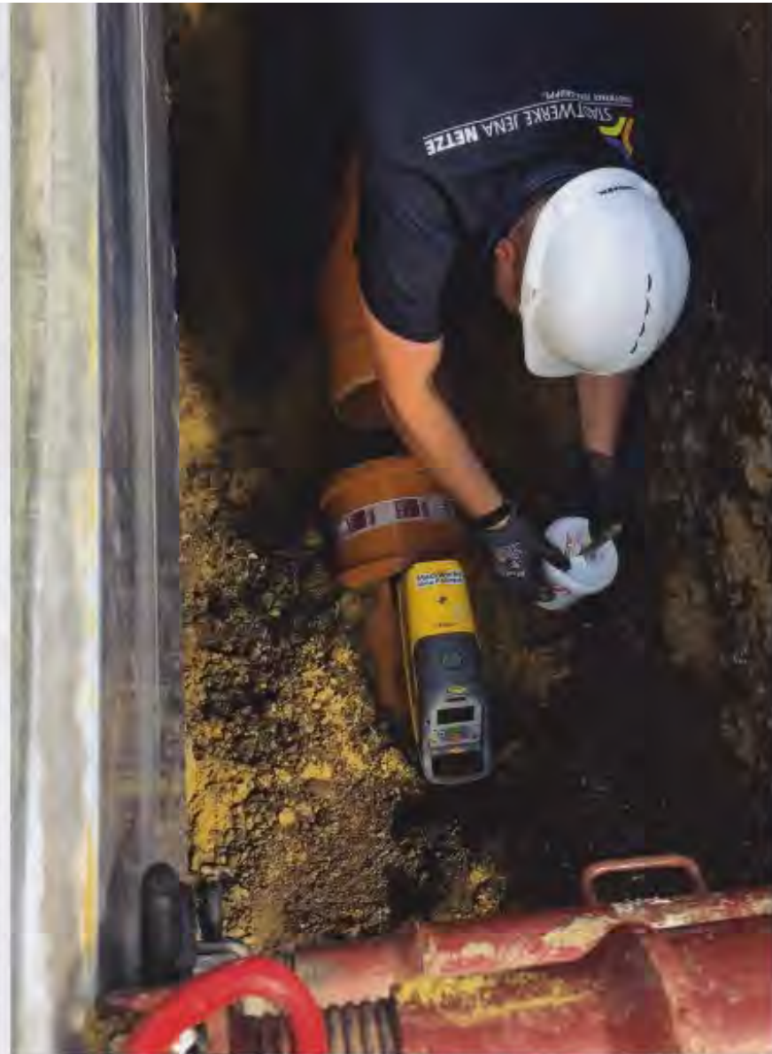
Bei Kanalbaumaßnahmen setzen die Stadtwerke Jena Netze auf Qualifikationsnachweise wie das Gütezeichen Kanalbau. Foto: Stadtwerke Jena Netze
