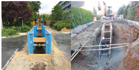
Bild 1. Fachgerecht (l.) und unsachgemäß (r.). Ein nicht fachgerecht eingestellter Verbau hat Einfluss auf das Gleichgewicht des umliegenden Erdreiches und kann zum Beispiel zu Setzungen führen, welche die angrenzende Bebauung erheblich schädigen kann.
