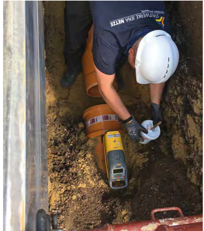
Bei Kanalbaumaßnahmen setzen die Stadtwerke Jena Netze auf Qualifikationsnachweise wie das Gütezeichen Kanalbau.
