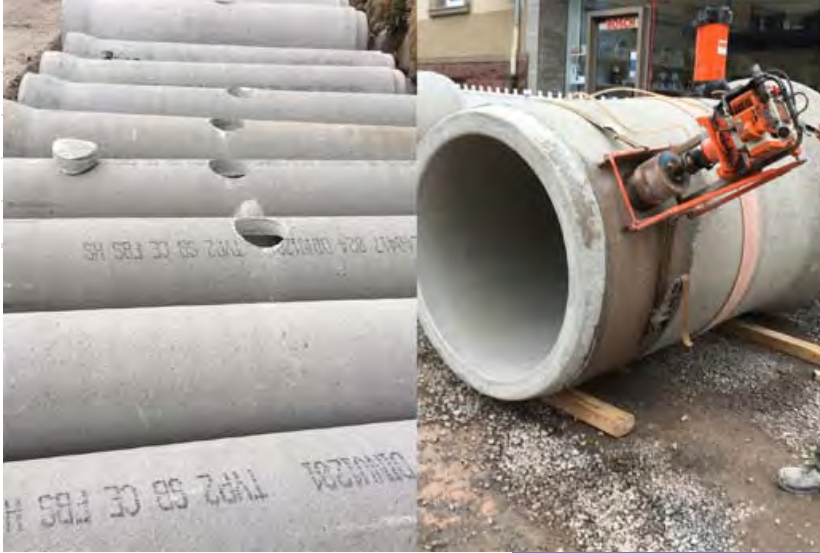
Foto: Güteschutz Kanalbau - Nicht fachgerecht (l.): Mittig oder gegenüber hergestellte Anschlussbohrungen
