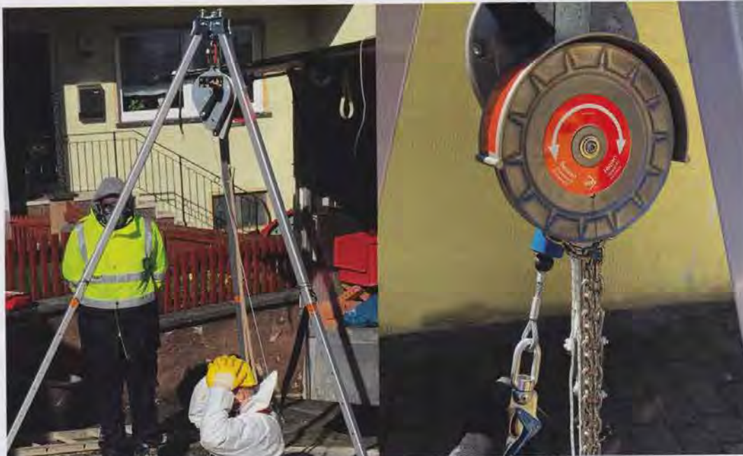
Nicht fachgerecht (l.): Der Anschlagpunkt ist nur für die Absturzsicherung geeignet, nicht für die Verwendung eines Höhensicherungsgerätes mit Kurbel zur Personenrettung. Fachgerecht (r.): Eine Rettungshub-Funktion hängt an einem geeigneten Anschlagpunkt ist nur mit Haspelkettenantrieb möglich. Foto: Güteschutz Kanalbau
