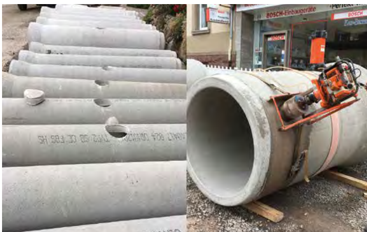
Nicht fachgerecht (l.): Mittig oder gegenüber hergestellte Anschlussbohrungen und deren mögliche Folgen. Fachgerecht (r.): Das Bohrergerät ist mit Spannbänder fixiert und die Bohrung wird an der richtigen Stelle ausgeführt.
