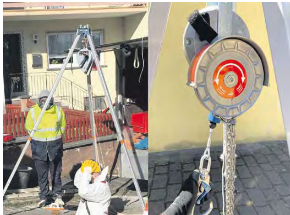
Nicht fachgerecht (l.): Der Anschlagpunkt ist nur für die Absturzsicherung geeignet, nicht für die Verwendung eines Höhensicherungsgerätes mit Kurbel zur Personenrettung. Fachgerecht (r.): Eine Rettungshub-Funktion hängt an einem geeigneten Anschlagpunkt ist nur mit Haspelkettenantrieb möglich.
