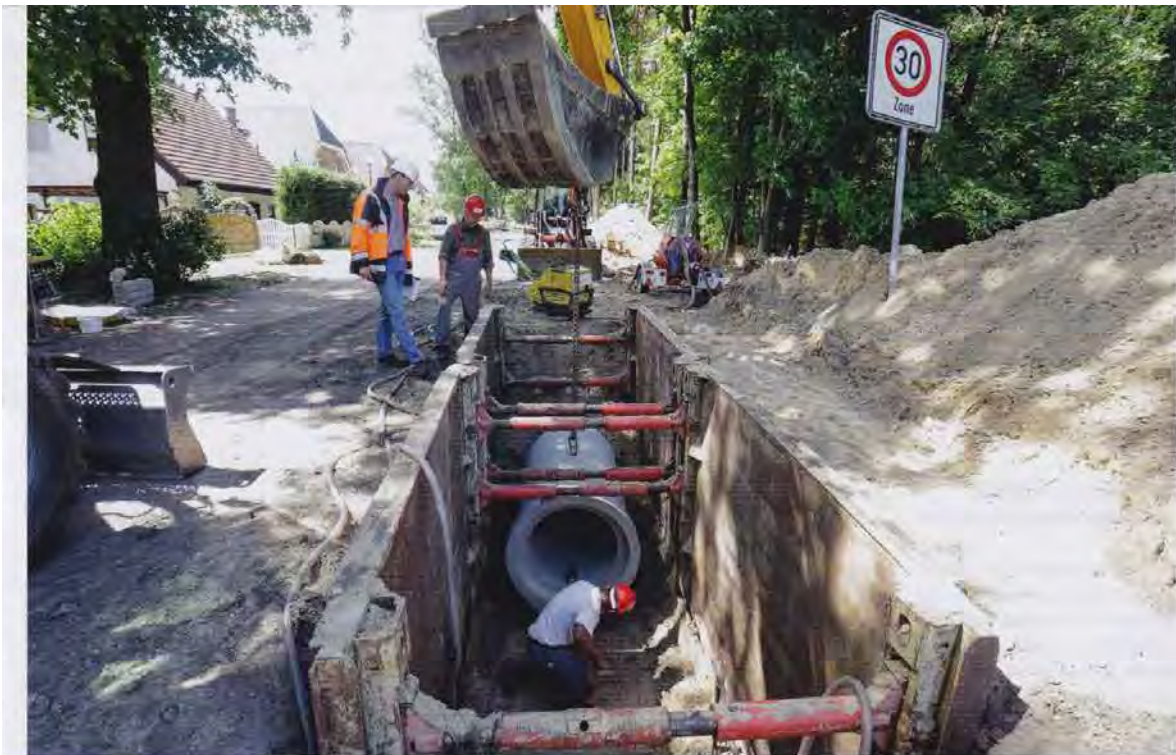
Wenn qualitätsbewusste Auftraggeber auf fachkundige und zuverlässige Planer und ausführende Unternehmen treffen, können entsprechende Maßnahmen in aller Regel in der notwendigen Qualität realisiert werden. Fotos: Güteschutz Kanalbau
