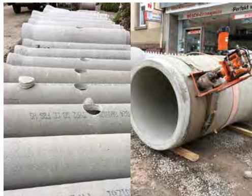
Abb. 3 und 4: Nicht fachgerecht (l.): Mittig oder gegenüber hergestellte Anschlussbohrungen und deren mögliche Folgen. Fachgerecht (r.) Das Bohrergerät ist mit Spannbänder fixiert und die Bohrung wird an der richtigen Stelle ausgeführt.
