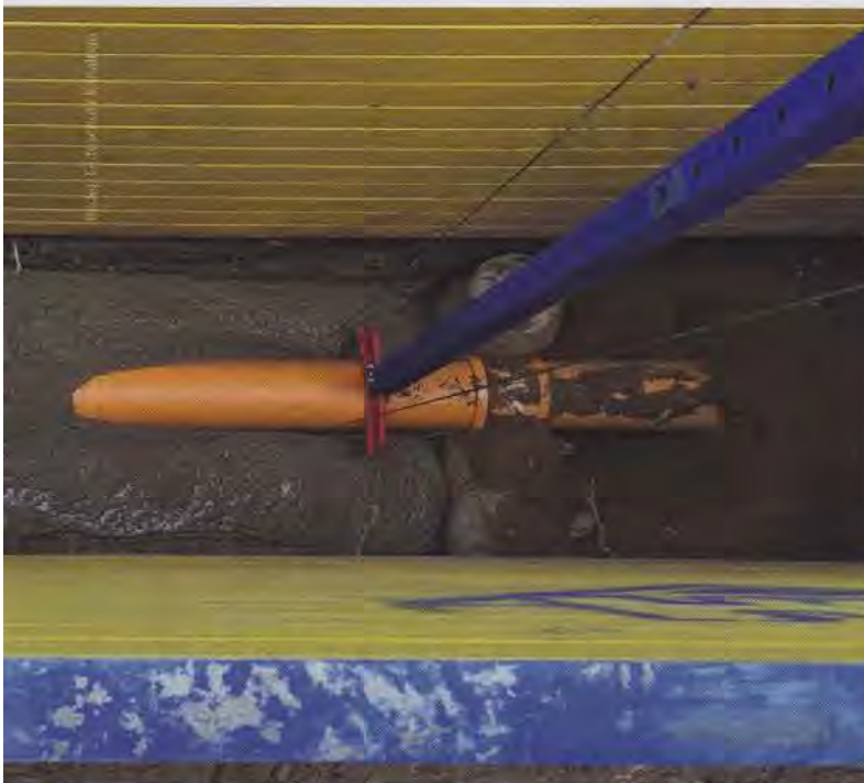
Der Einsatz von Flüssigboden nimmt zu. Was bei seiner Verwendung auf der Baustelle beachtet werden muss, darüber informiert ein neuer Leitfaden Eigenüberwachung der Gütegemeinschaft Kanalbau.
