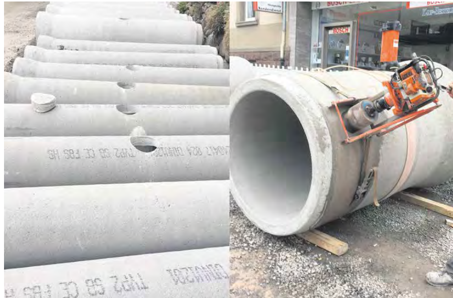
Nicht fachgerecht (l.): Mittig oder gegenüber hergestellte Anschlussbohrungen und deren mögliche Folgen. Fachgerecht (r.) Das Bohrgerät ist mit Spannbänder fixiert und die Bohrung wird an der richtigen Stelle ausgeführt.
