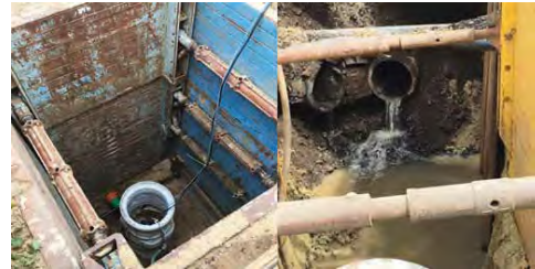
Bild 2. Fachgerecht (l.) und unsachgemäß (r.). Aussparungen im Verbausystem sind grundsätzlich nicht zulässig – die Verkleidung muss vollflächig sein.
