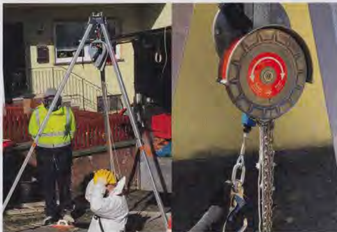
Bild 1 und Bild 2 . Nicht fachgerecht (l.): Der Anschlagpunkt ist nur für die Absturzsicherung geeignet, nicht für die Verwendung eines Höhensicherungsgerätes mit Kurbel zur Personenrettung. Fachgerecht (r.): Eine Rettungshub-Funktion hängend an einem geeigneten Anschlagpunkt ist nur mit Haspelkettenantrieb möglich
