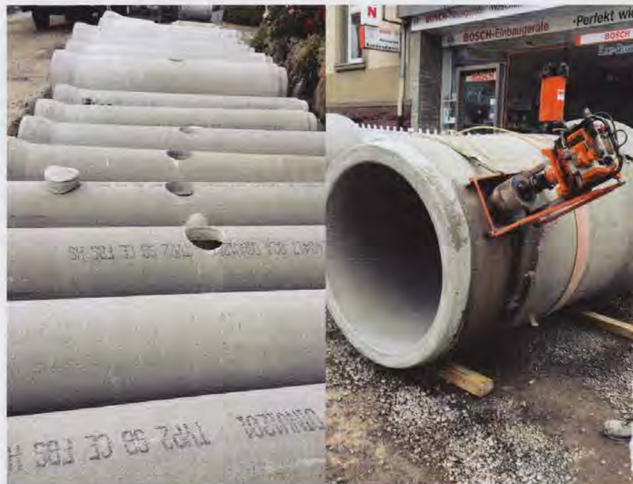
Nicht fachgerecht (l.): Mittig oder gegenüber hergestellte Anschlussbohrungen und deren mögliche Folgen. Fachgerecht (r.): Das Bohrgerät ist mit Spannbänder fixiert und die Bohrung wird an der richtigen Stelle ausgeführt. Foto: Güteschutz Kanalbau
