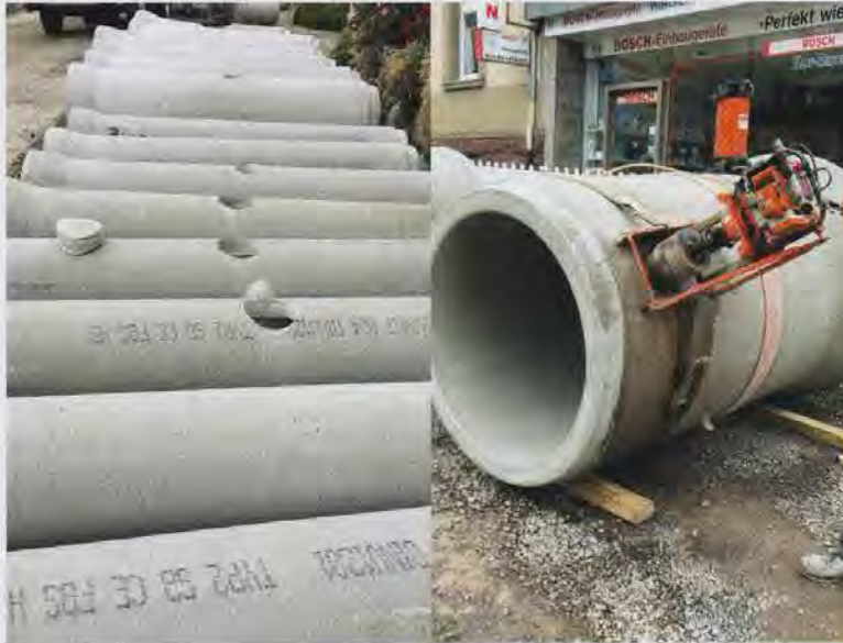
Bild 3 + 4. Nicht fachgerecht (l.): Mittig oder gegenüber hergestellte Anschlussbohrungen und deren mögliche Folgen. Fachgerecht (r.): Das Bohrgerät ist mit Spannband fixiert und die Bohrung wird an der richtigen Stelle ausgeführt. (Fotos: Güteschutz Kanalbau)
