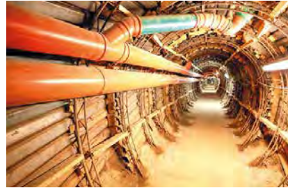
Im Stollenquerschnitt sind neben der Stromversorgung für die Beleuchtung und anderer technischer Geräte noch die Bewetterung sowie die provisorische Abwasserleitung untergebracht.
