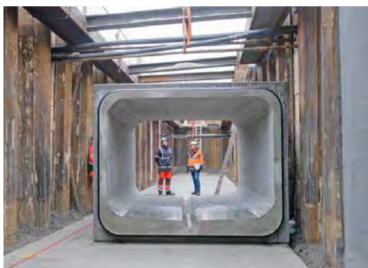
Wichtiger Bestandteil der Gütesicherung ist die Überprüfung der Gütezeicheninhaber durch einen unabhängigen Prüfsingenieur.
