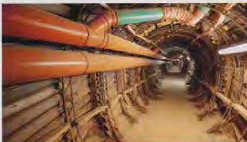
Bild 1: Im Stollenquerschnitt sind neben der Stromversorgung für die Beleuchtung und anderer technischer Geräte noch die Bewetterung sowie die provisorische Abwasserleitung untergebracht
