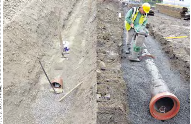
Angeschütteter, nicht verdichteter Bereich der Leitungszone und der Abdeckung (l.);
