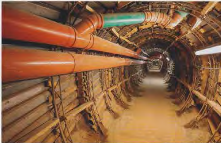
Im Stollenquerschnitt sind neben der Stromversorgung für die Beleuchtung und anderer technischer Geräte noch die Bewetterung sowie die provisorische Abwasserleitung untergebracht.
