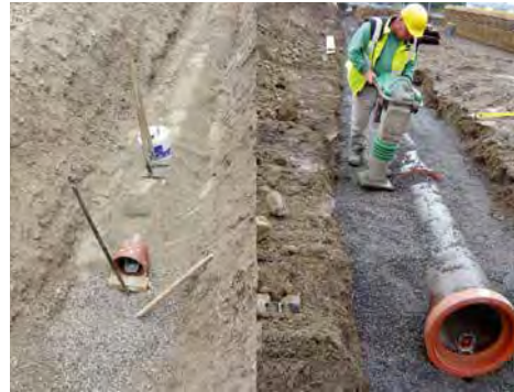
Angeschütteter, nicht verdichteter Bereich der Leitungszone und der Abdeckung (l.); Lagenweiser Einbau Verdichtung über die gesamte Grabenbreite (r.).
