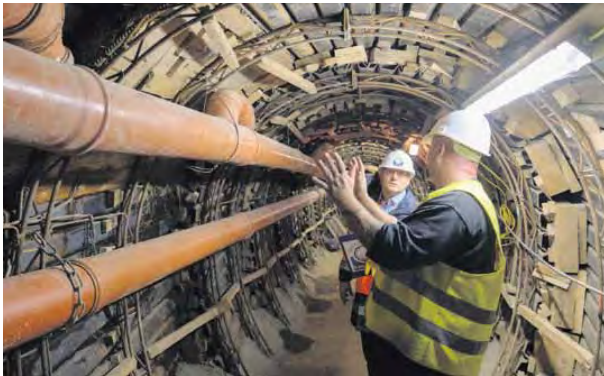
ARGE-Polier Ingo Heidgen erläutert Prüflingenieur Marc Mielke die Vorgehensweise beim Umschluss der Hausanschlussleitungen an die provisorische Abwasserleitung.
