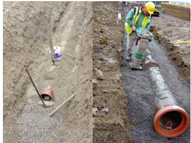
Angeschütteter, nicht verdichteter Bereich der Leitungszone und der Abdeckung (l.); Lagenweiser Einbau Verdichtung über die gesamte Grabenbreite (r.).
