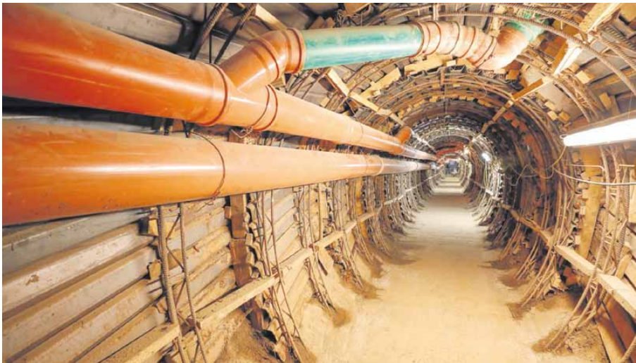
Im Stollenquerschnitt sind neben der Stromversorgung für die Beleuchtung und anderer technischer Geräte noch die Bewetterung sowie die provisorische Abwasserleitung untergebracht.
