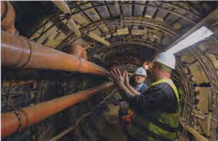
ARGE-Polier Ingo Heidgen erläutert Prüflingenieur Marc Mielke die Vorgehensweise beim Umschluss der Hausanschlussleitungen an die provisorische Abwasserleitung. | Fotos: Güteschutz Kanalbau
