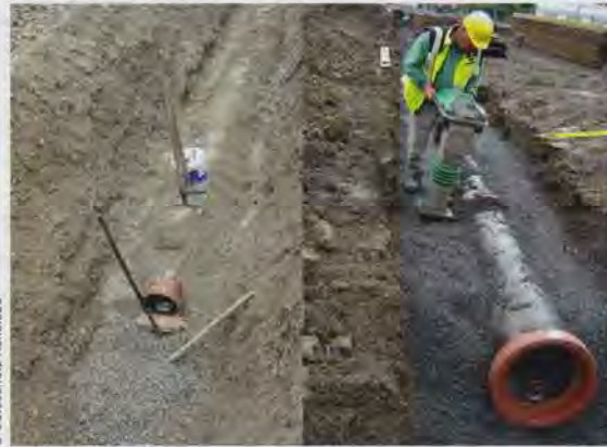
Angeschütteter, nicht verdichteter Bereich der Leitungszone und der Abdeckung (l.); Lagenweiser Einbau Verdichtung über die gesamte Grabenbreite (r.).
