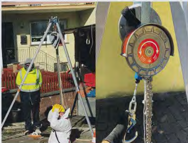
Bild 1. + 2. Nicht fachgerecht (l.): Der Anschlagpunkt ist nur für die Absturzsicherung geeignet, nicht für die Verwendung eines Höhensicherungsgerätes mit Kurbel zur Personenrettung. Fachgerecht (r.): Eine Rettungshub-Funktion hängt an einem geeigneten Anschlagpunkt ist nur mit Haspelkettenantrieb möglich.
