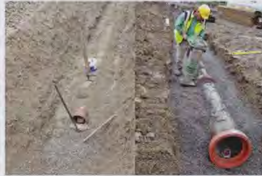
Angeschütteter, nicht verdichteter Bereich der Leitungszone und der Abdeckung (l.); Lagenweiser Einbau der Verdichtung über die gesamte Grabenbreite (r.)
