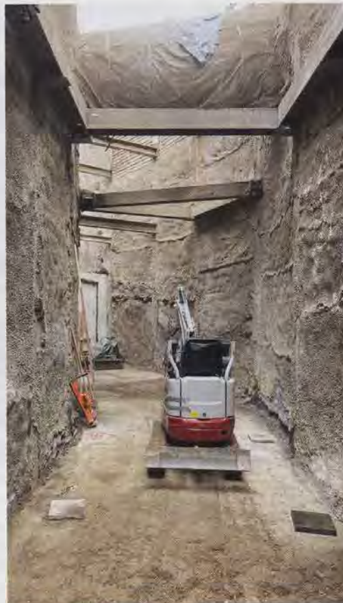
In rund 7,5 m Tiefe erfolgen die Arbeiten zum Umbau und der Erweiterung des SKU. Gut zu erkennen ist eine der beiden kreuzenden Ferngasleitungen, in deren Schutzbereich alle Arbeiten erschütterungsfrei erfolgen müssen.
