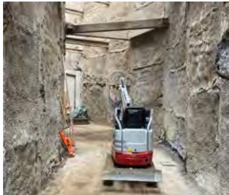
In rund 7,5 Metern Tiefe erfolgen die Arbeiten zum Umbau und der Erweiterung des SKU. Gut zu erkennen ist eine der beiden kreuzenden Ferngasleitungen, in deren Schutzbereich alle Arbeiten erschütterungsfrei erfolgen müssen.
