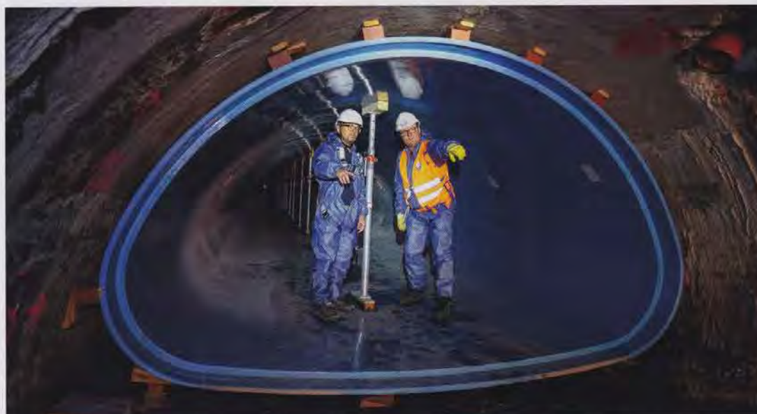
Bild 5: Die GFK-Rohre werden mit Hilfe von Ziegelsteinen und Holzkeilen in ihrer Lage gesichert. Die Baustützen verhindern ein Aufwölben des Sohlbereiches während der Ringraumverdümmung. Im Gespräch Aarsleff Oberbauleiter Johannes Leewe (li.) und Güteschutz Prüflingenieur Guido Heidbrink (re.).
