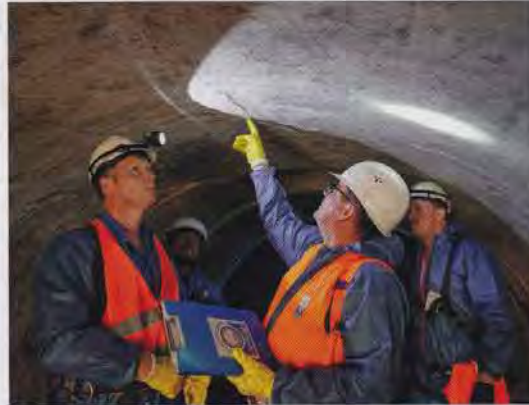
Bild 4: Risse im Scheitelbereich der Lutter-Verrohrung gehörten zum Schadensbild. V. l. n. r.: Alexander Garen (Umweltbetrieb der Stadt Bielefeld), Johannes Leewe (Aarsleff Rohrsanierung), Guido Heidbrink (Güteschutz Kanalbau) und Klaus Schultz (Umweltbetrieb der Stadt Bielefeld).
