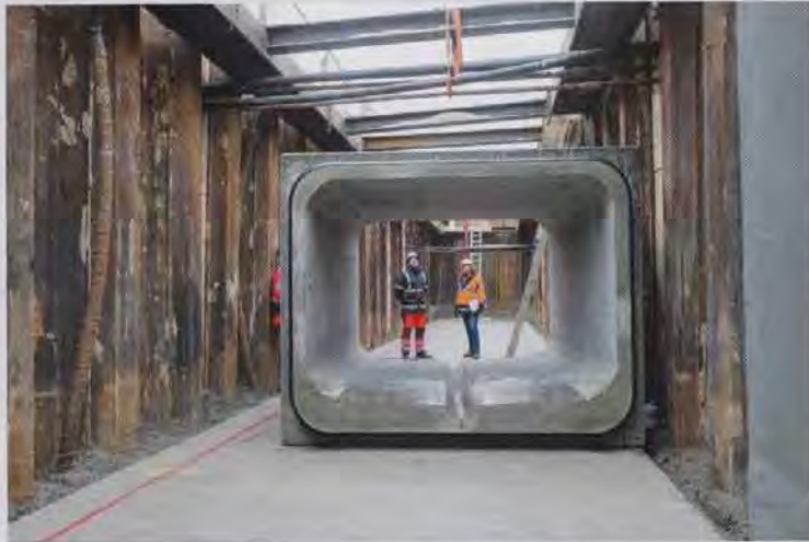
Bild 2 Ein wichtiger Bestandteil der Gütesicherung ist die Überprüfung der Gütezeicheninhaber durch einen unabhängigen Prüflingenieur, der vom Güteausschuss des Güteschutz Kanalbau beauftragt ist. Quelle: Güteschutz Kanalbau
