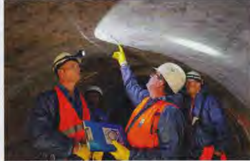
Risse im Scheitelbereich der Lutter-Verrohrung gehörten zum dem Schadensbild. V. l. n. r.: Alexander Garen (Umweltbetrieb der Stadt Bielefeld), Johannes Leewe (Aarsleff Rohrsanierung), Guido Heidbrink (Güteschutz Kanalbau) und Klaus Schultz (Umweltbetrieb der Stadt Bielefeld).
