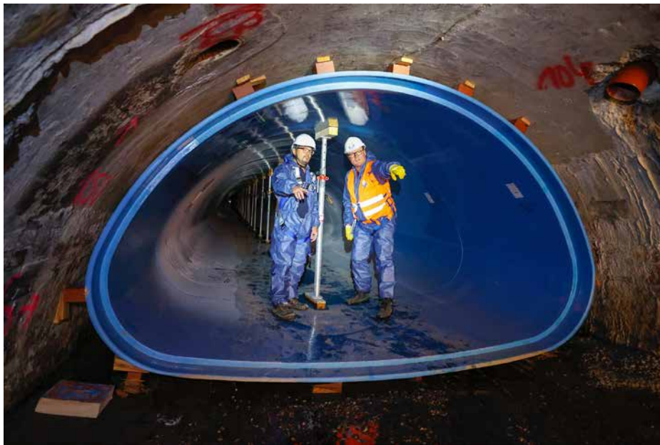
Um 1900 wurde in Bielefeld die Weser-Lutter verrohrt und parallel ein Schmutzwassersammler errichtet. Heute, nach rund 120 Jahren, hat sich der bauliche Zustand beider Bauwerke derart verschlechtert, dass eine Sanierung der Verrohrung und des Schmutzwasserkanals unumgänglich war. Foto: Güteschutz Kanalbau
