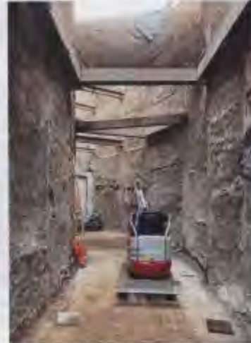
In rund 7,5 m Tiefe erfolgen die Arbeiten zum Umbau und der Erweiterung des Stauraumkanals. Gut zu erkennen ist eine der beiden kreuzenden Ferngasleitungen, in deren Schutzbereich alle Arbeiten erschütterungsfrei erfolgen müssen.
