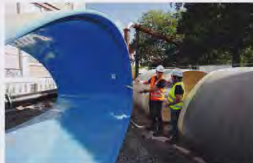
Unterschiedliche Rohrdimensionen: Güteschutz Prüflingenieur Guido Heidbrink (li.) überprüft zusammen mit Aarsleff Oberbauleiter Johannes Leewe die Wandstärke der GFK-Rohre. Foto: Güteschutz Kanalbau
