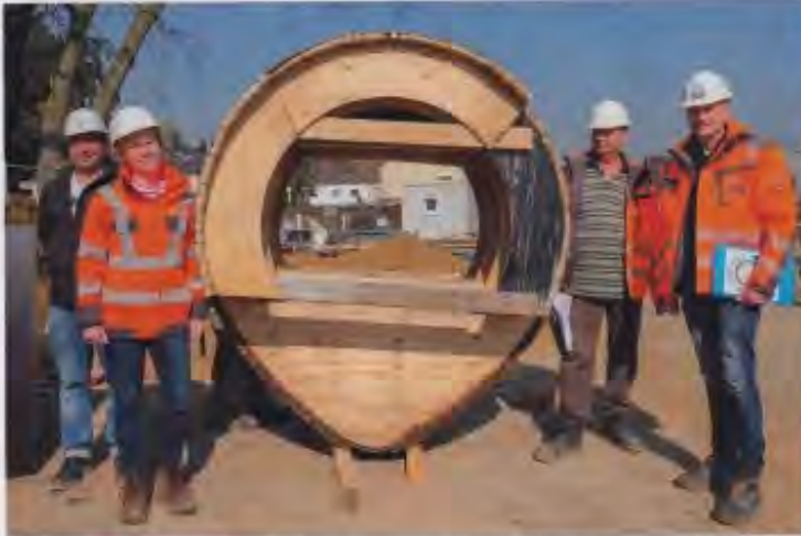
Ein produktives Miteinander für ein erfolgreiches Projekt (v.l.n.r.): Thomas Schacht (Stadtentwässerungsbetriebe Köln AöR), Britta Heitkamp und Uwe Zimmer (beide Heitkamp IB) und Prüfingenieur Joachim Oligschläger (Güteschutz Kanalbau).
