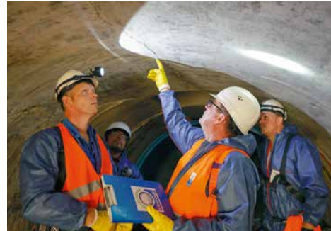
Risse im Scheitelbereich der Lutter-Verrohrung gehörten zum dem Schadensbild. V. l. n. r.: Alexander Garen (Umweltbetrieb der Stadt Bielefeld), Johannes Leewe (Aarsleff Rohrsanierung), Guido Heidbrink (Güteschutz Kanalbau) und Klaus Schultz (Umweltbetrieb der Stadt Bielefeld). Baustellen.
