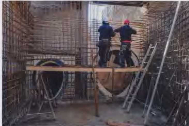
In dem Verbindungsbauwerk treffen der alte Entlastungskanal (Elprofil 800/1400, links im Bild) und der neu errichtete, zusätzliche Entlastungskanal (1700/1890, rechts) zusammen. Von hier führt der Entlastungskanal in der Dimension 2000/2225 zu dem Hochwasserdoppelschieber.
