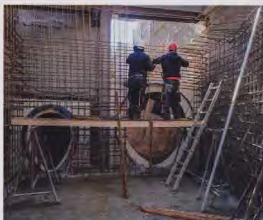
Bild 4: In dem Verbindungsbauwerk treffen der alte Entlastungskanal (Eiprofil 800/1400, li. im Bild) und der neu errichtete, zusätzliche Entlastungskanal (1700/1890, re.) zusammen. Von hier führt der Entlastungskanal in der Dimension 2000/2225 zu dem Hochwasserdoppelschieber
