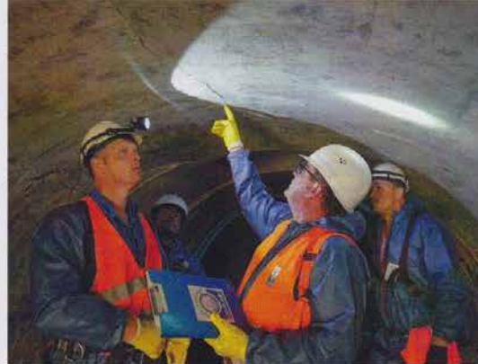
Bild 4: Risse im Scheitelbereich der Lutter-Verrohrung gehörten zum dem Schadensbild. V. l. n. r.: Alexander Garen (Umweltbetrieb der Stadt Bielefeld), Johannes Leewe (Aarsleff Rohrsanierung), Guido Heidbrink (Güteschutz Kanalbau) und Klaus Schultz (Umweltbetrieb der Stadt Bielefeld).
