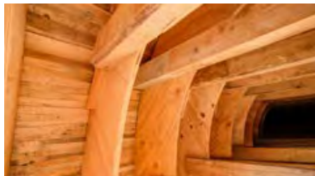
Ein Blick in die Schalung des neuen Entlastungskanals 2000/2225 zeigt die umfangreiche Handarbeit.
